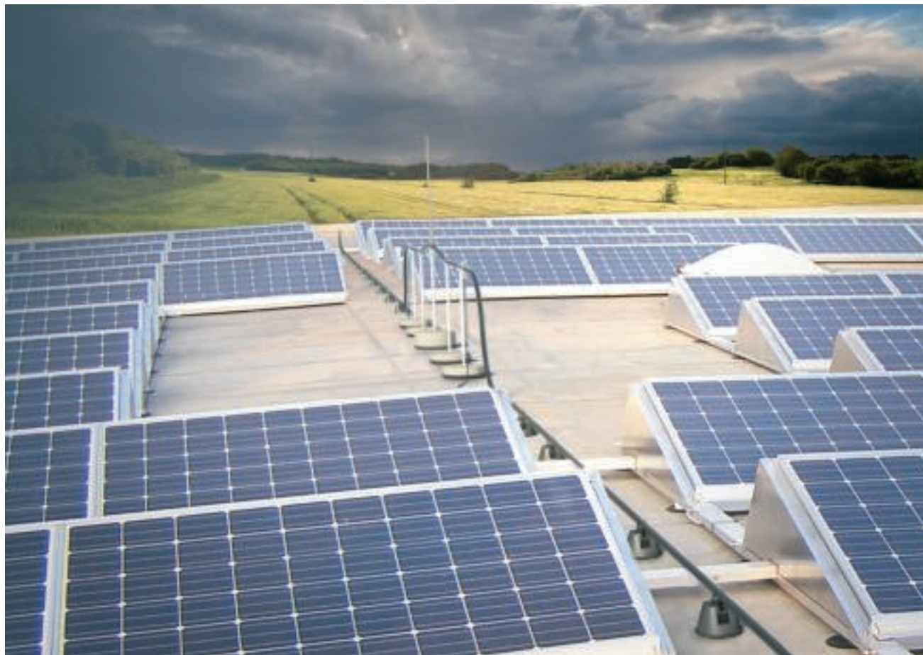
Lēzenais jumts ar fotoelektrisko sistēmu un izolētu isCon® vadu
