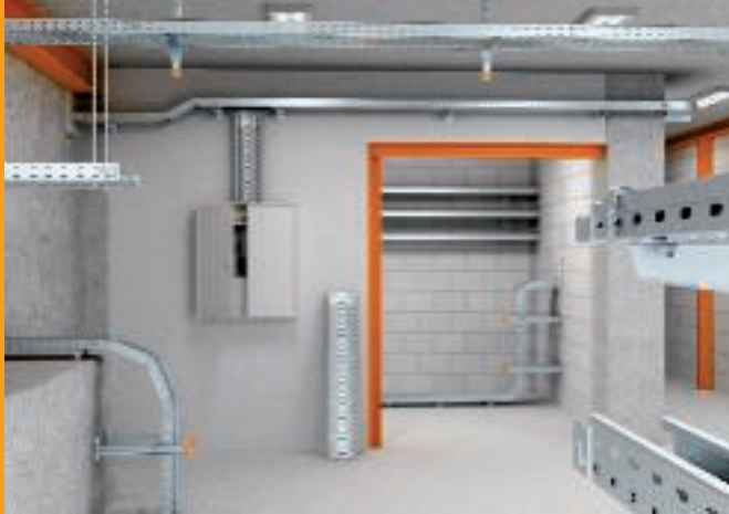
Kabeļu reņu sistēmas
