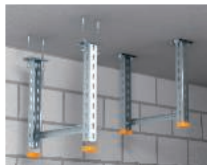
Traversa U veida iekaramo statņu US 3 K, US 5 K un US 7 K montāža zem griestiem ar enkurtaipām un šķērssiju, kas izveidota no U profila US 3, US 5 vai US 7.
