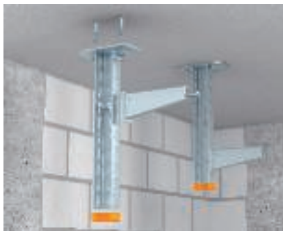
Iekārtā statņa standarta montāža ar sienas balsteni vienā pusē, neizmantojot paplāksni Iekārtā statņa nostiprināšana pie griestiem ar vienā pusē piemontētu balsteni. Līdz 300 mm platumam (ieskaitot) paplāksne nav nepieciešama.
