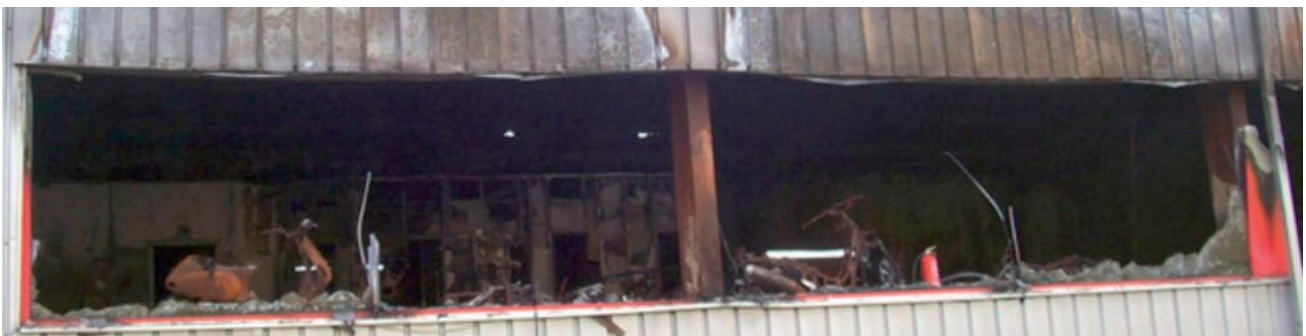
Korodējošu gāzu radīts bojājums ugunsgrēkā
